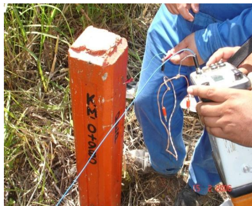
Medición de potenciales en el PPC.
