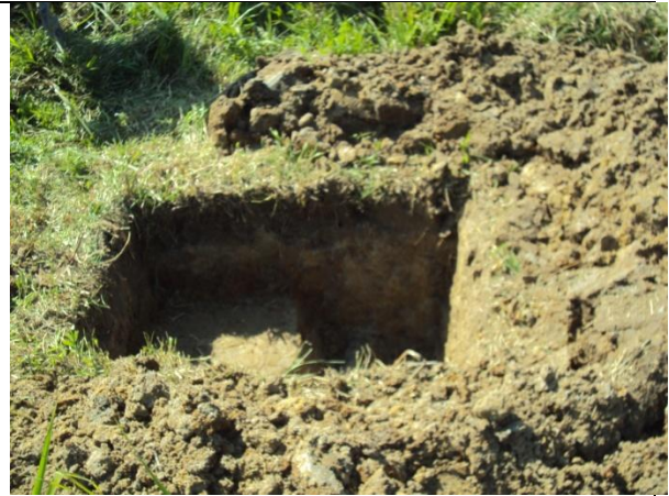
Ducto al descubierto
