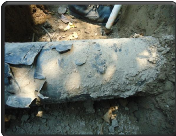
Anomalías en el recubrimiento
